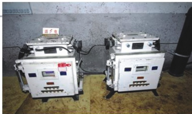
避难硐室电力系统
